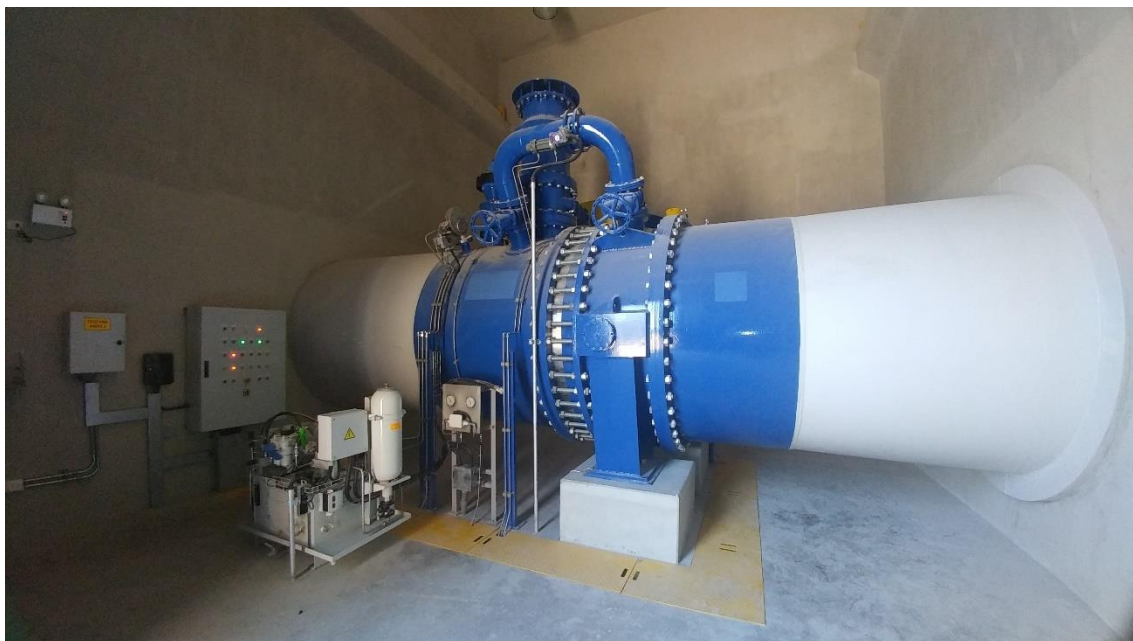
Fotografía 2. Válvula Mariposa (Válvula de Cabecera)
